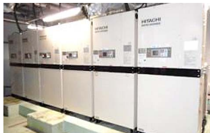
更新後冷凍機
