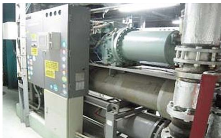
更新前冷凍機
