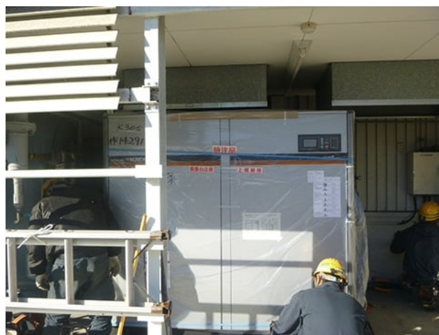
更新したエアコンプレッサ
