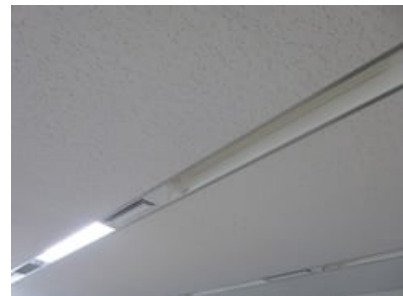
間引かれた電灯
