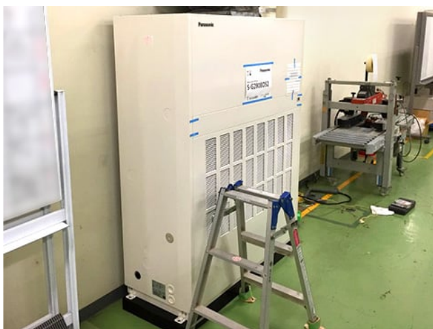
更新したエアコン
